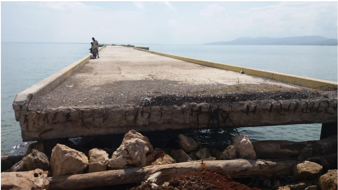
Détérioration du nouveau wharf de Jérémie
