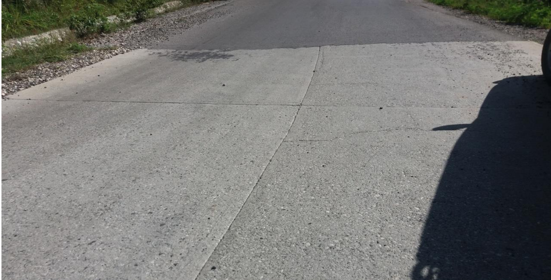
Connexion de la chaussée en béton hydraulique et celle en béton bitumineux
