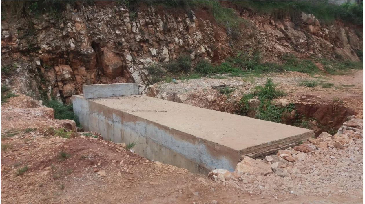
Travaux de drainage inachevé
