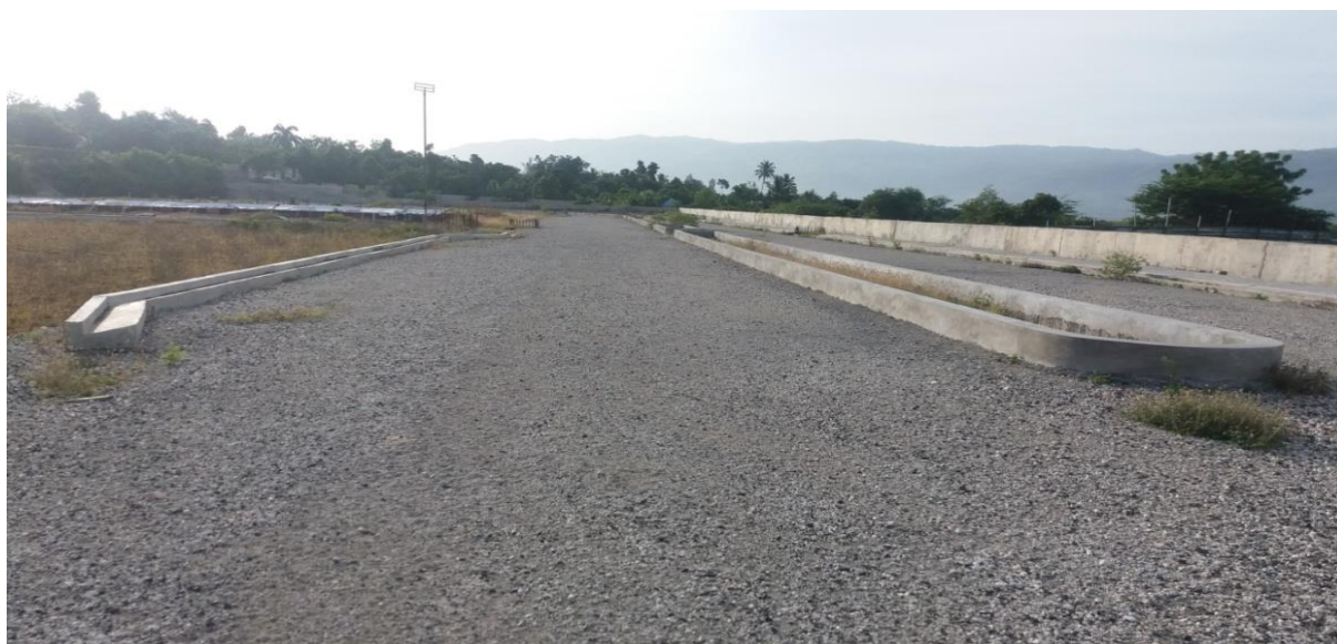
Etat de la voie d'accès de la gare de Miragoâne
