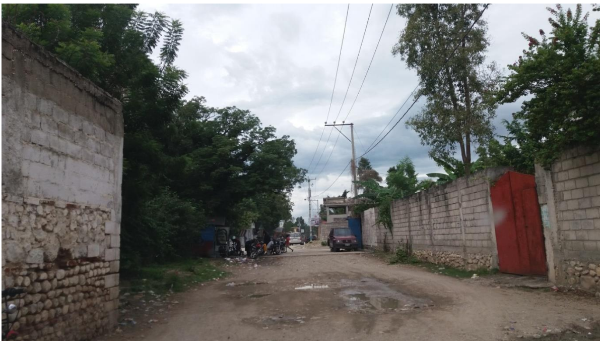
Rue en mauvais état de ville de Hinche
