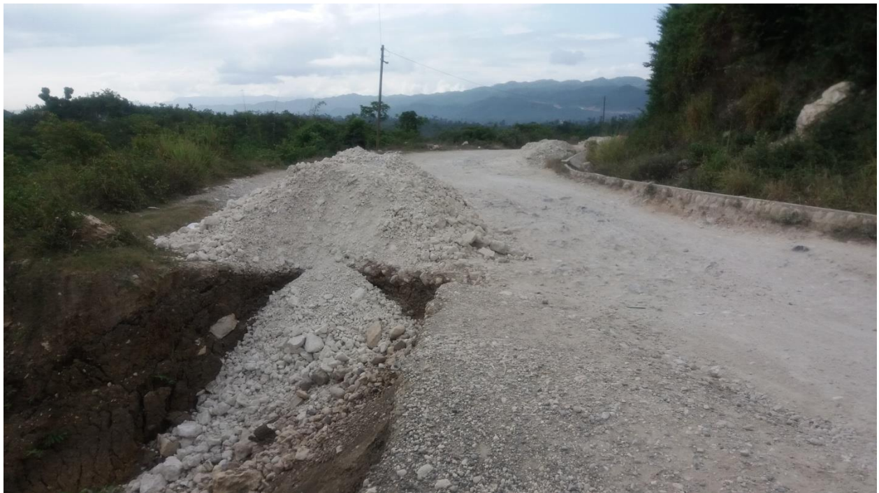
Effondrement de la base de la route Cayes-Jérémie
