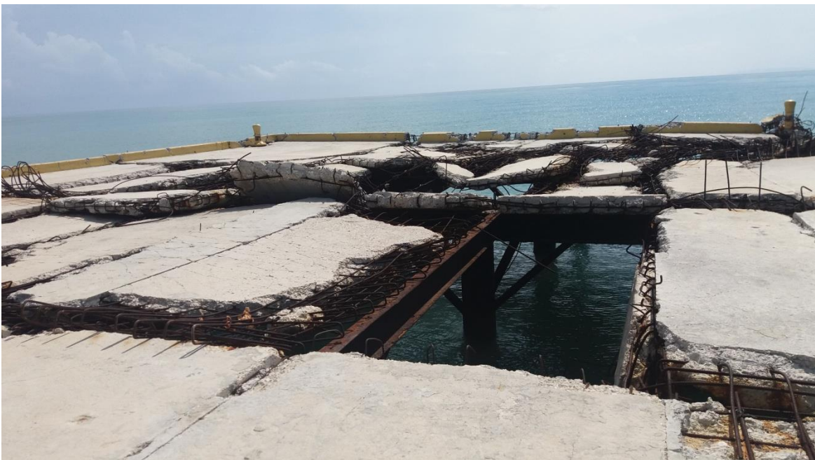
Détérioration du tablier du wharf
