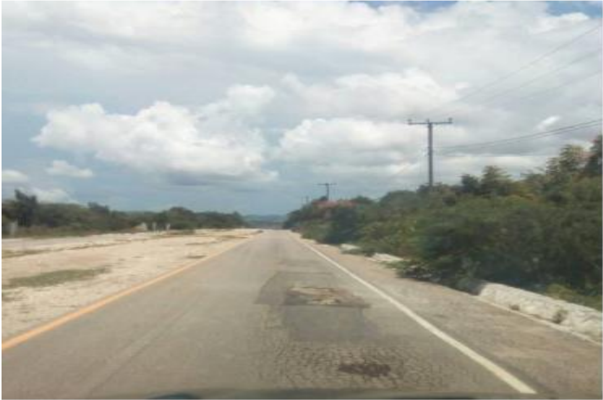
Route Carrefour 44/Cotes-de-Fer en dégradation
