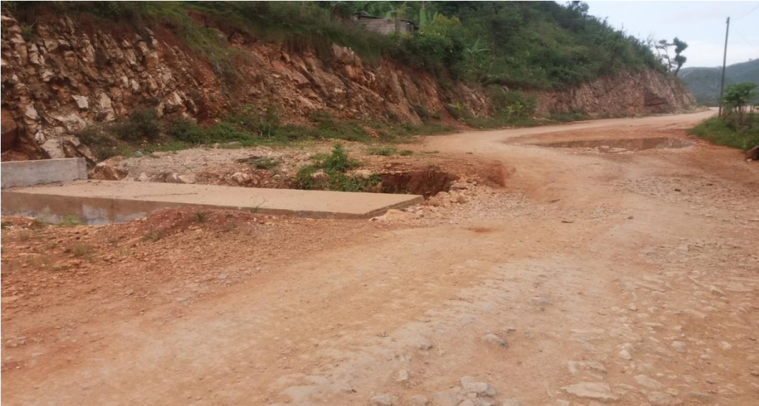
Travaux de drainage inachevé, Duchity
