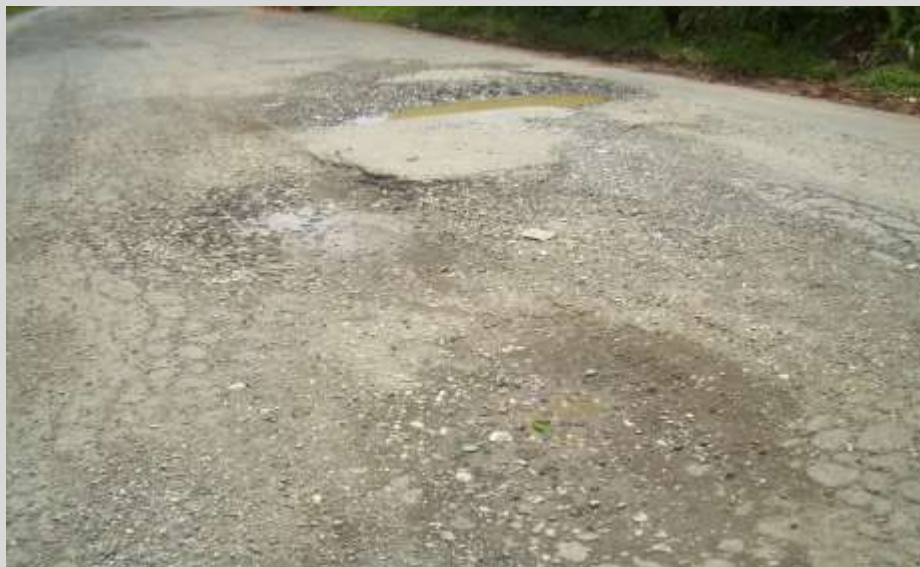
Photo présentant la chaussée fortement dégradée de la Route Carrefour Puilboreau - Marmelade
